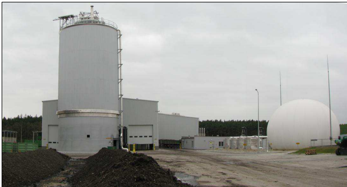
Rysunek 2.29 Hala technologiczna suchej fermentacji, komora fermentacyjna i zbiornik biogazu – fot. proGEO
