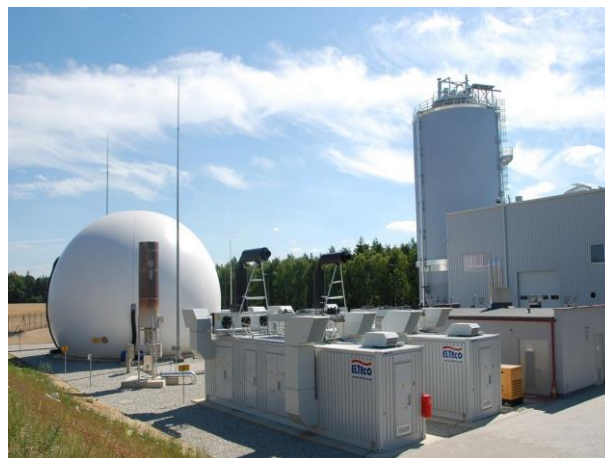
Rys. 33. Agregaty kogeneracyjne, zbiornik biogazu źródło: www.mzoleszno.com.pl
