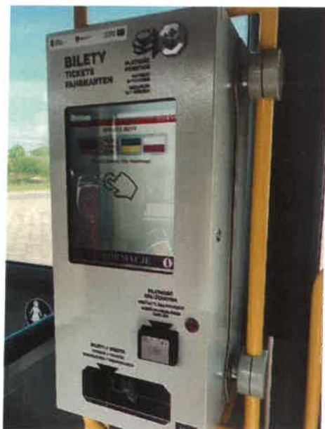
Zdjęcie 3 Zamontowany biletomat na pokładzie autobusu hybrydowego.
